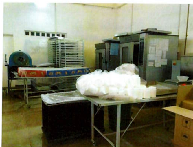
Figura 16 - Visão geral da área dos fornos
